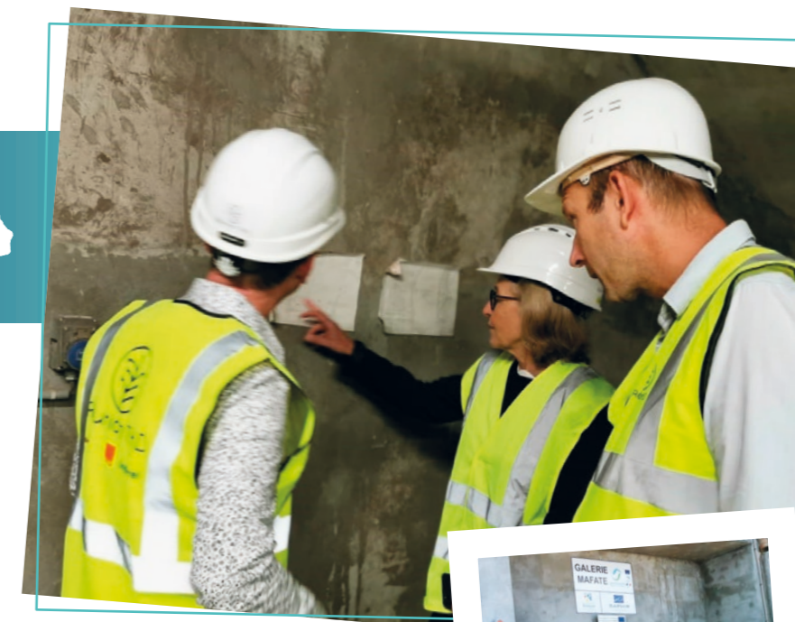
↑ Visite d'une galerie avec les équipes de Réunion THD, de Sogetrel et Orange Concessions.
