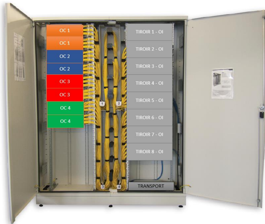
Armoire « Indoor » 2 x 40U (Exemple de tiroirs de distribution en 4U)
